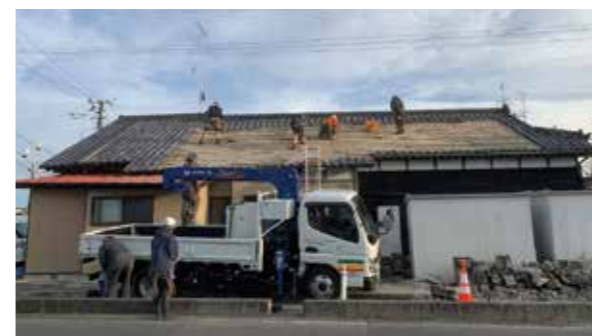
地震でずれ落ちた屋根瓦の応急処置(福島県南相馬市)
