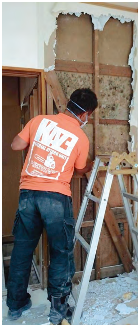
壁をはがすとカビが生えている
